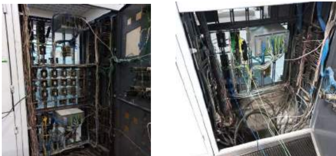
Рисунок 2 – Внешний вид ячейки фидера контактной сети 27,5 кВ с подключенным измерительным оборудованием
